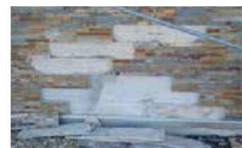
Delaminación de la piedra
