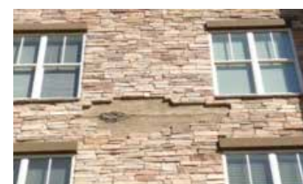
Fallas de adherencia
